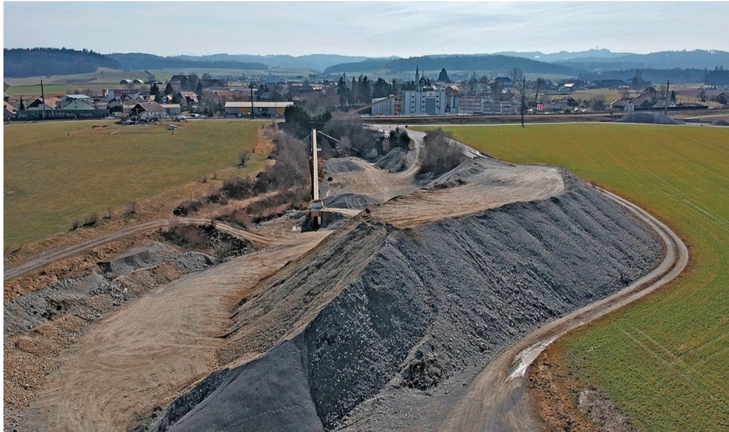
Die Firma Hofstetter will den Kies weitere zehn Jahre nahe ihrem Betonwerk (im Hintergrund) zwischenlagern. Foto: Beat Mathys
