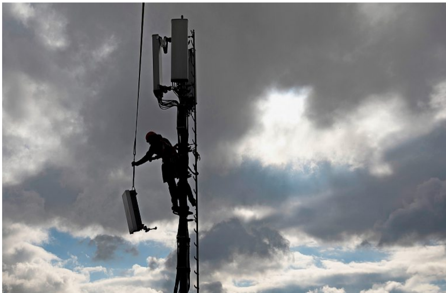
Immer wieder gut für Diskussionen: Eine Mobilfunkantenne wird auf 5G-Standard aufgerüstet. Foto: Keystone
